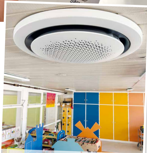
Deux grandes climatisations ont été installées pour faire des salles, des lieux refuges.
